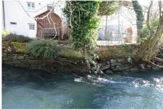
Abbildung 27 Grössere Schadenstelle in der Kleinen Aare
