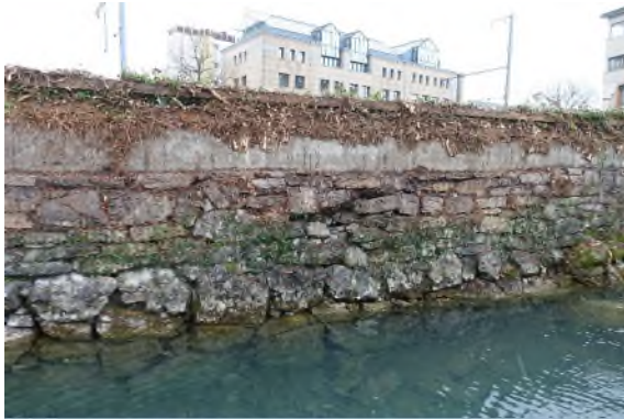
Abbildung 26 Lokale Schadenstelle in der Grossen Aare
