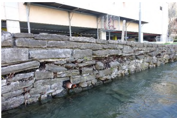
Abbildung 28 Schäden durch Knöterich in der Kleinen Aare
